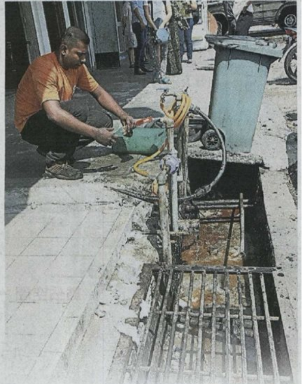
▲沟渠积满至少半呎的油污，且发出臭味。
